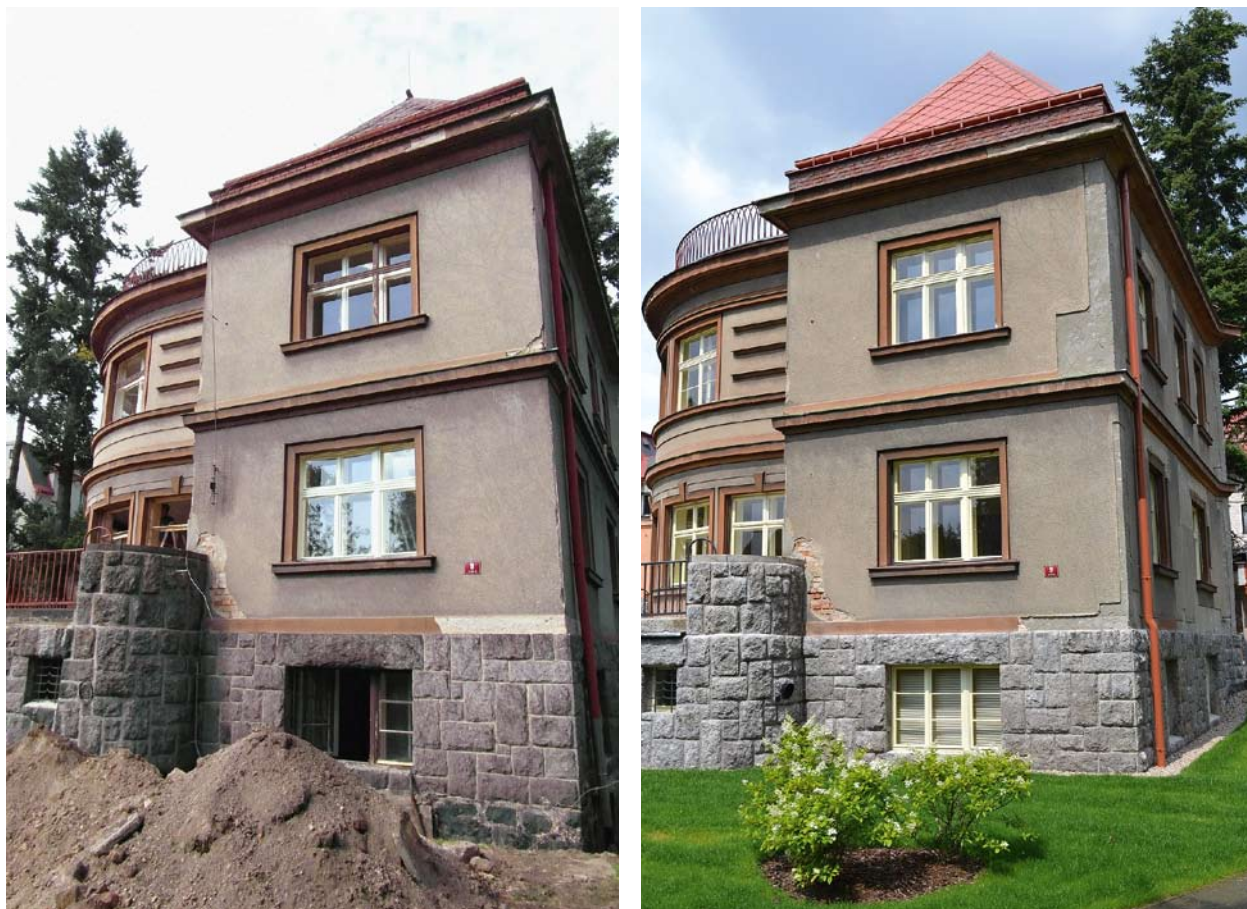
Obr. 27. Schneiderova vila, Jablonec nad Nisou, Zlatá 2912/9. Sokl z žulových kvádrů byl otryskán a přespárován, na fasádě jsou patrné odstraněné části omítek, které budou doplněny „břízolitem“ co nejbližším původní struktuře a barevnosti. Celek nebude opatřován sjednocující stěrkou ani fasádním nátěrem, doplňované části tak budou rozpoznatelné. (foto P. Freiwillog)
