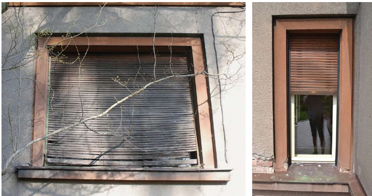
Obr. 28. Schneiderova vila, Jablonec nad Nisou, Zlatá 2912/9. Stav dřevěných žaluzií na dvou rozdílných oknech před a po obnově. (foto P. Freiwilfig)
