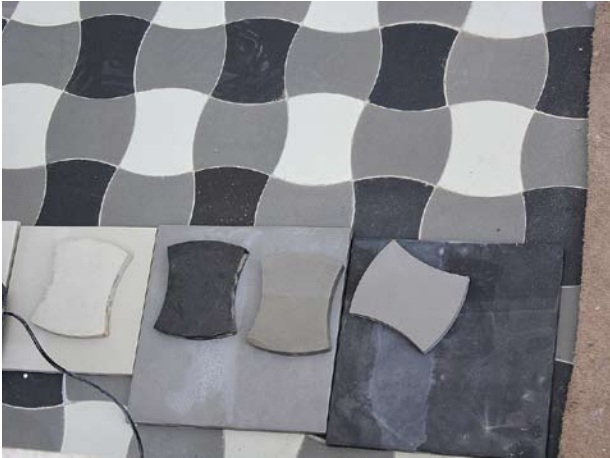
Obr. 17. Vila Stiassni, Brno, Hroznová 82/14. Podlaha přízemí služebního schodiště během obnovy – vzorek „piškotků“ vyřezaných vodním paprskem ze standardního formátu. Smyslem vzorku bylo ověřit shodu barevnosti – únor 2014 (foto M. Solarř)
