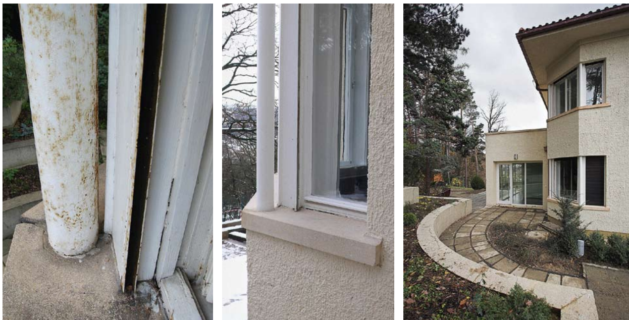
Obr. 38. Malotova vila, Zlín, Lazy čp. 3689. Detaily nárožních oken s vodícími lištami venkovních rolet a parapety z umělého kamene před obnovou a po obnově. (foto Petr Všecká a Toast images, 2006–2007)
