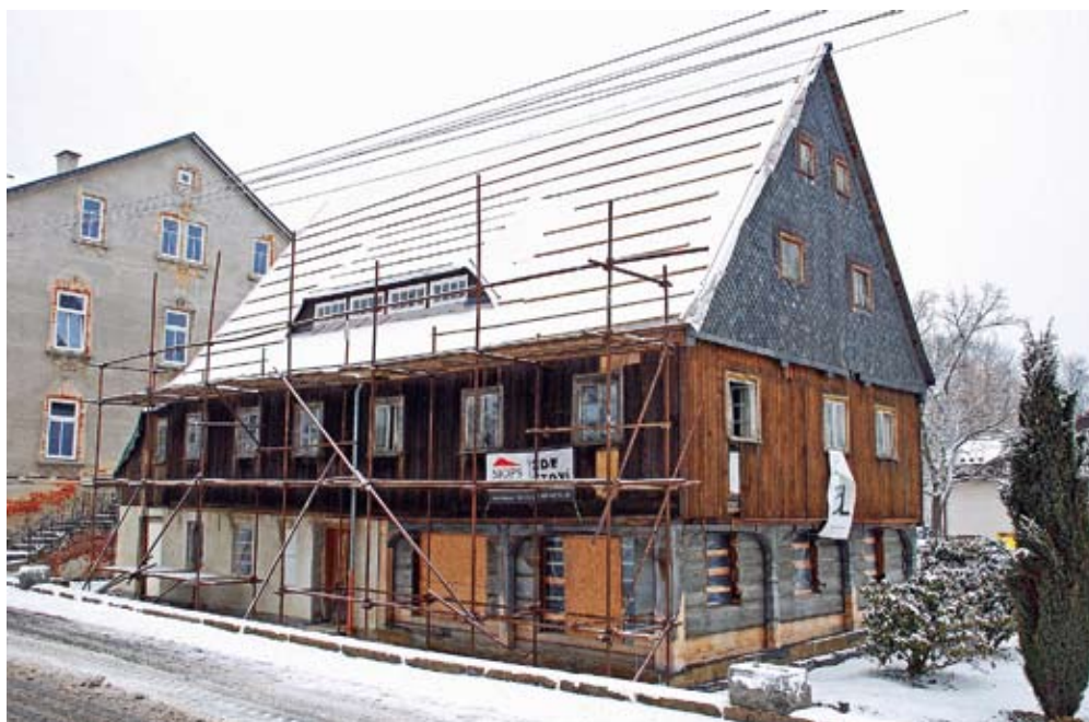
Dům čp. 424, celkový pohled na dům od jihu během rekonstrukce (Buková – okres Děčín, foto J. Pešta, 2012).
