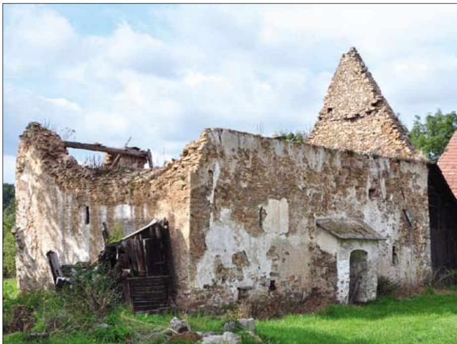
Obr. 28: Postupně zanikající, pravděpodobně pozdně gotická sýpka u čp. 9 v Radošovicích – okres Strakonice je dokladem, že ani mnohé nejstarší a nejhodnotnější stavby našeho venkova stále nejsou po technické stránce zajištěny. Stavba měla donedávna ještě zachovanou střechu, rovněž štít zanikl v posledních letech (foto J. Pešta, 2013).
