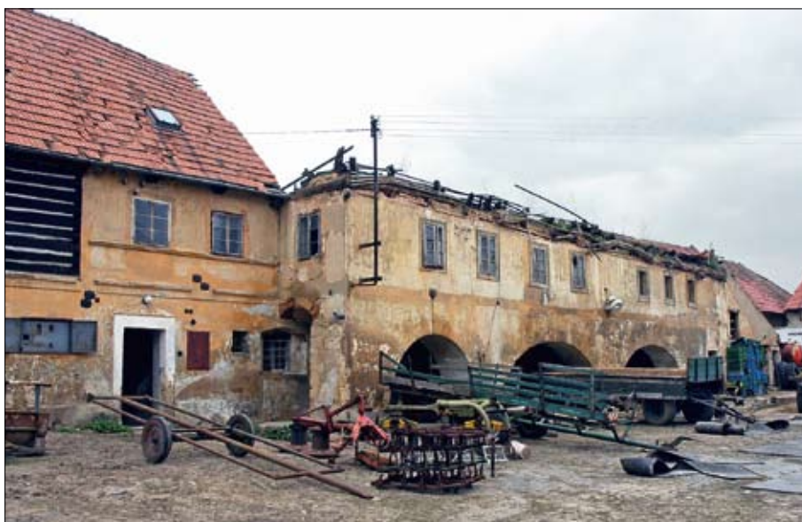
Obr. 5: Těchohubuzice – okres Litoměřice, usedlost čp. 12 je příkladem ohrožené mimořádně hodnotné stavby, patřící k nejvýznamnějším o regionu (foto J. Pešta, 2007).
