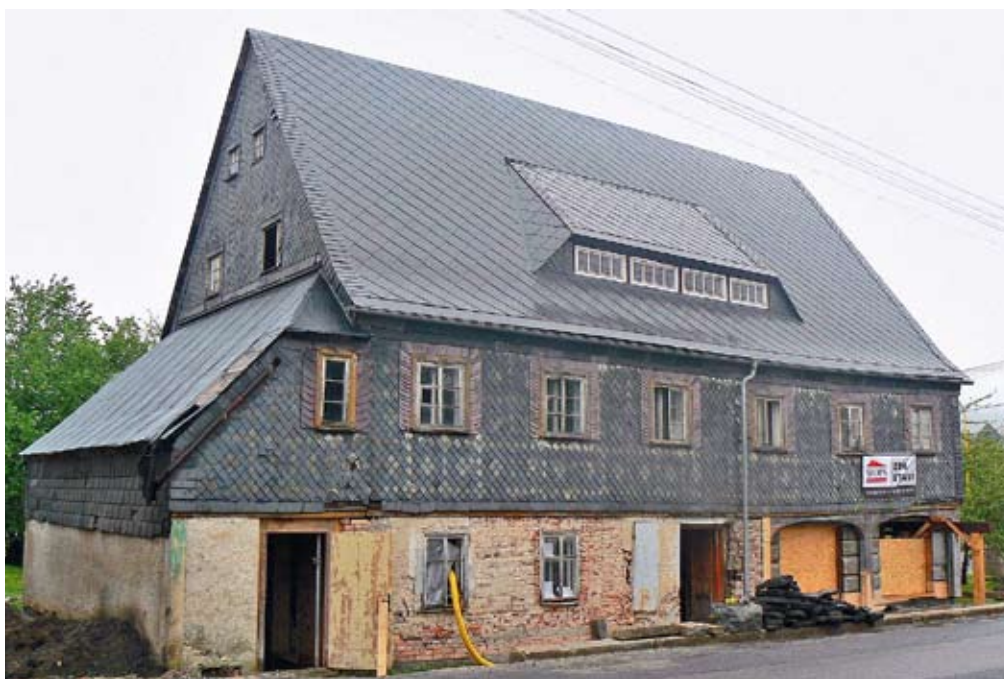
Dům čp. 424, celkový pohled na dům od západu před zahájením rekonstrukce (Buková – okres Děčín, foto T. Efler, 2010).
